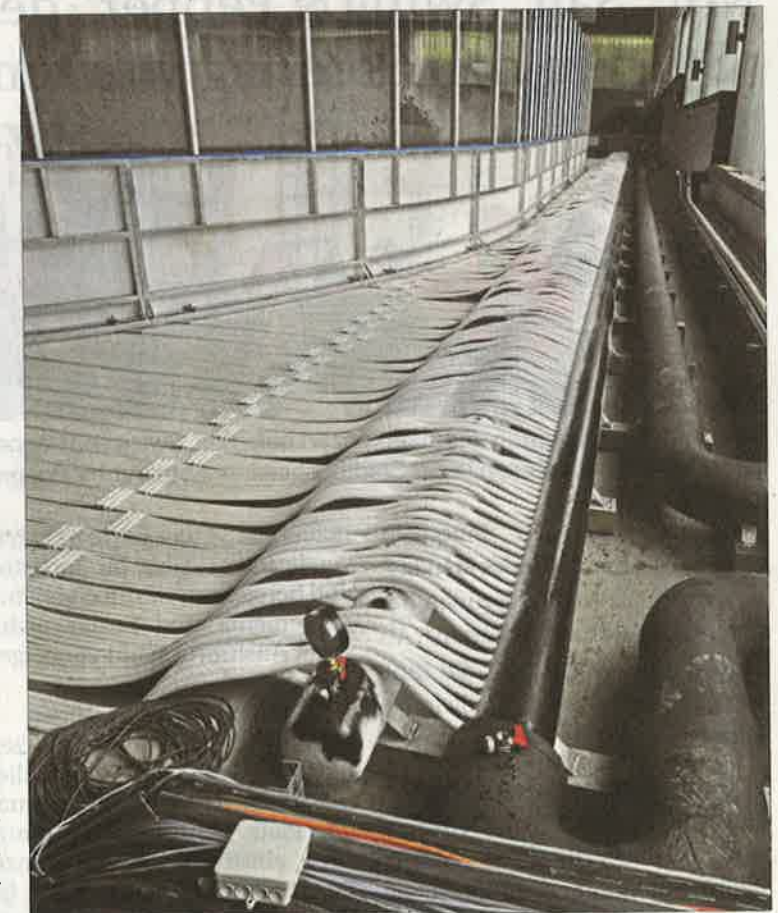
Von der Kälteanlage, die jetzt außerhalb der Halle steht, fließt die eiskalte Sole durch dicke Leitungen in die Halle und von ihnen in die dünnen weißen Schläuche, die auf dem Hallenboden verlegt sind.
